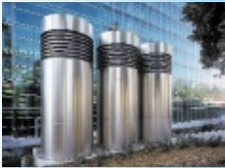
Entrées d'air pour le système de refroidissement naturel du nouveau bâtiment de l'OMM.
